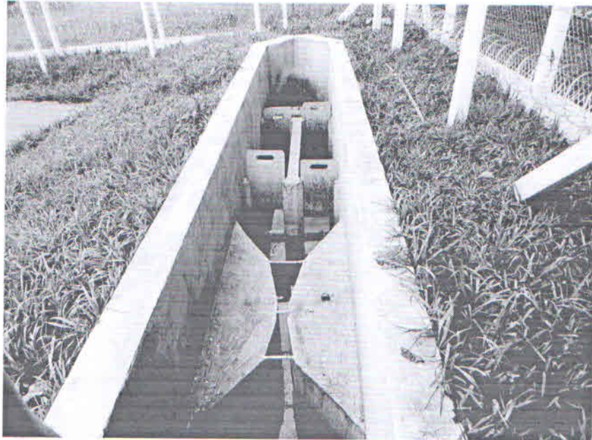
Foto 7.5 – Tratamento preliminar (Calha Parshal e Caixa de Areia).
